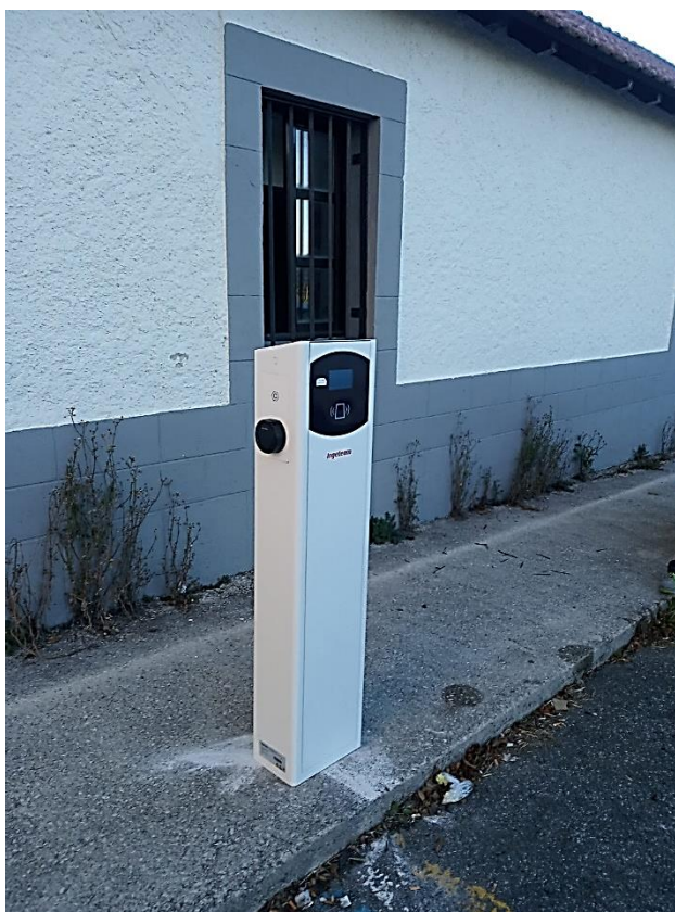
Ilustración 4. Punto de recarga de vehículos eléctricos en Orreaga/Roncesvalles
