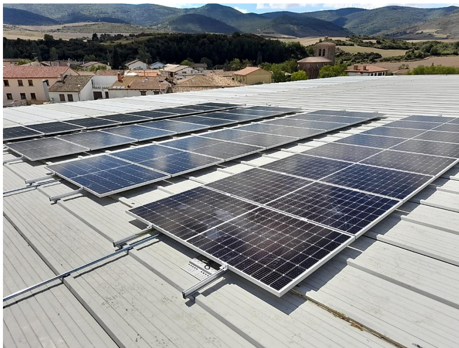
Ilustración 2. Instalación solar fotovoltaica en cubierta del frontón de Salinas de Ibargoiti/Getze Ibargoiti
