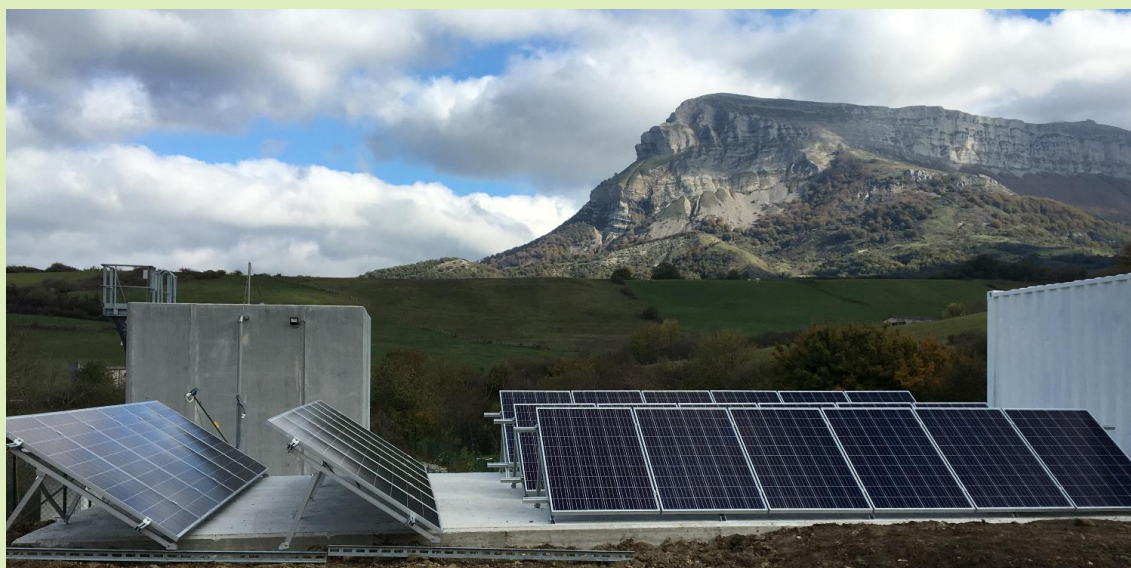
Instalaciones de la microrred de Lizarraga-Ergoiena
